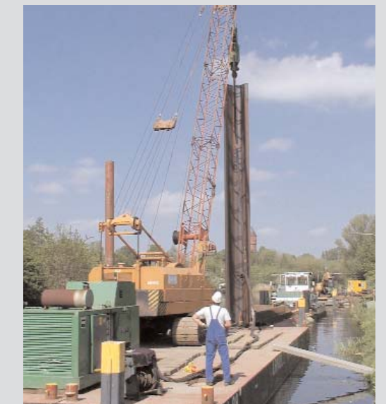
Einrichtung der Wartestelle an der Schleuse Lübz
