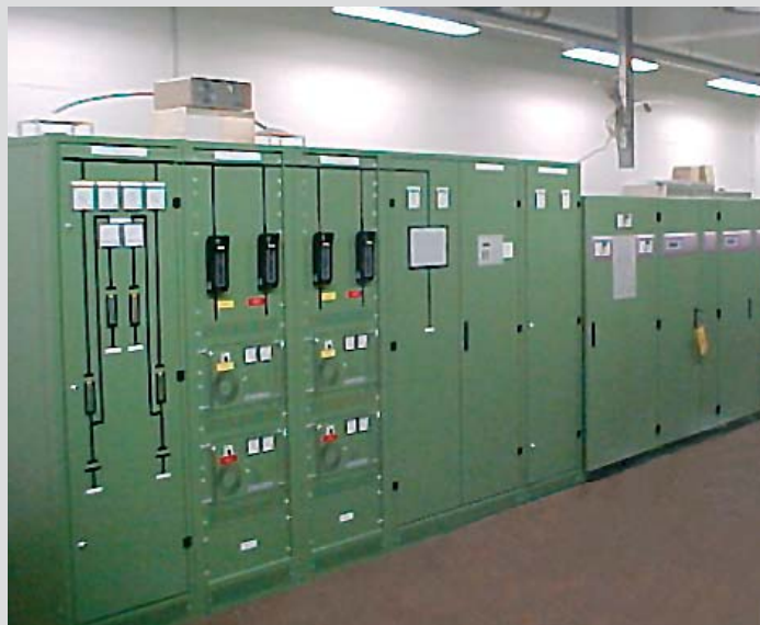
24-V-DC-Versorgung und 230-V-AC USV-Anlage in Kraftwerkstechnik zur Aufrechterhaltung der Sicherheitstechnik eines Gasspeichers.
