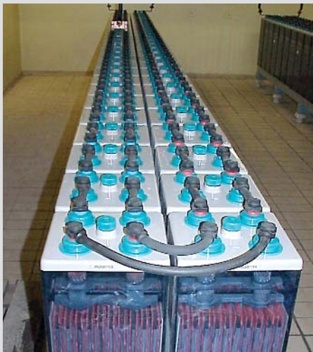
220-V-Batterieanlage mit einer Nennkapazität von 1000 Ah zur Sicherung der Steueranlagen eines Energieversorgers.
